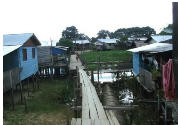
Foto 2: Tubería que vierte alcantarillado
